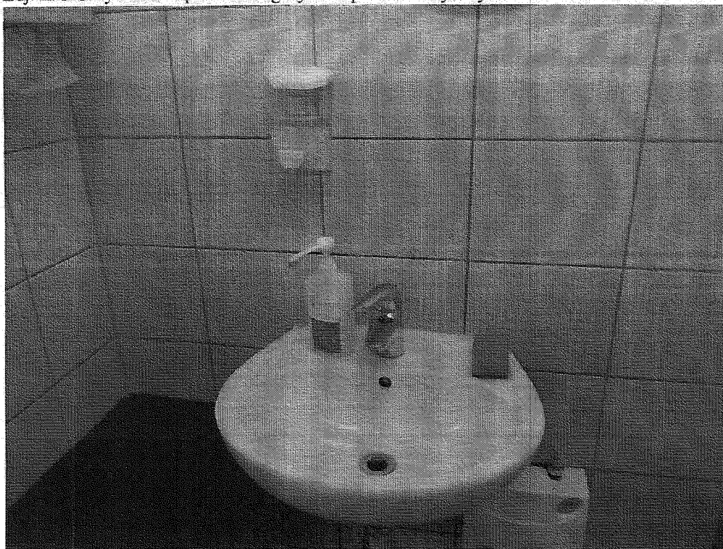
Zdj. nr 3 Umywalka w pobliżu magazynu odpadów medycznych
