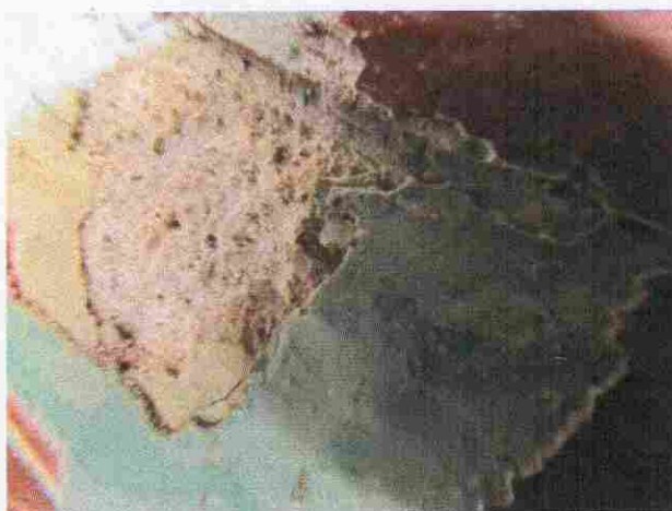
Il.6 widok na ścianę -2 piętro z widocznymi warstwami wymalowani
