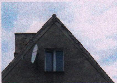
SZCZYT WSCHODNI OKNO DO WYMIANY
