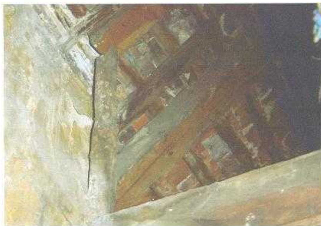
Fot. 6. Widoczny brak wymianu przy kominie, skrócona krokiew oparta za pośrednictwem łaty na jętcie opartej na kominie.
