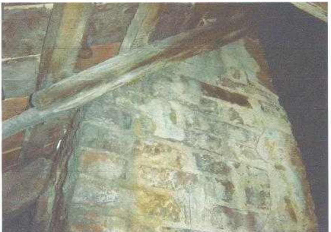
Fot. 4. Widoczny brak wymianu przy kominie, skrócona krokwie oparta bezpośrednio na kominie, przeswit między dachówką a kominem świadczący o braku opierzenia.
