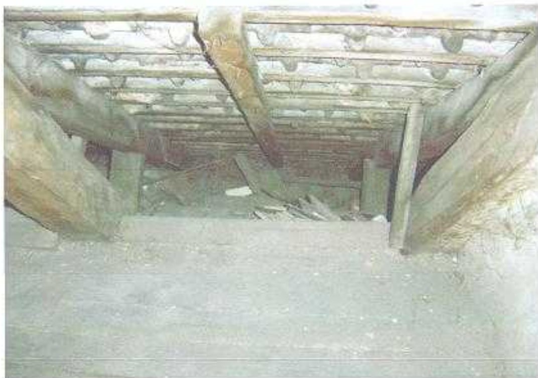
Fot. 5 Widoczne zamieszanie przestrzeni uniesionej polaci nad lukarną, próba wzmocnienia uginających się lat, poprzez nabicie łaty prostopadle.
