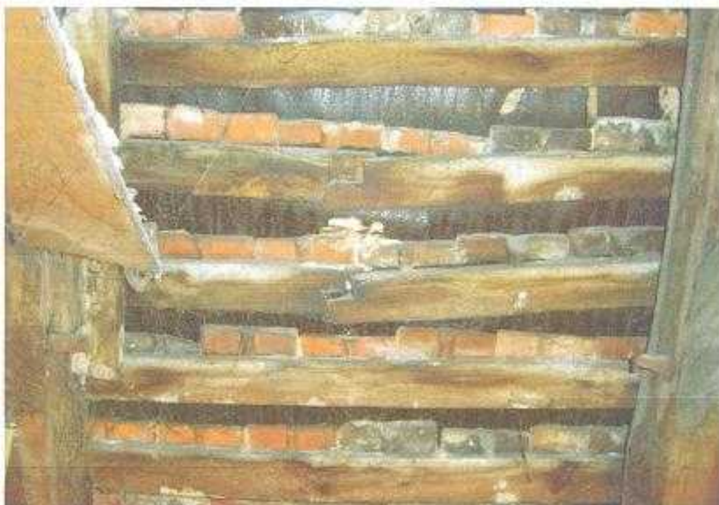
Fot. 8. Widoczne ugięcia i przemieszczenie łąty na łączeniach. Nieprawidłowe łączenie łąty w przęśle zamiast w miejscu oparcia na krokwi.
