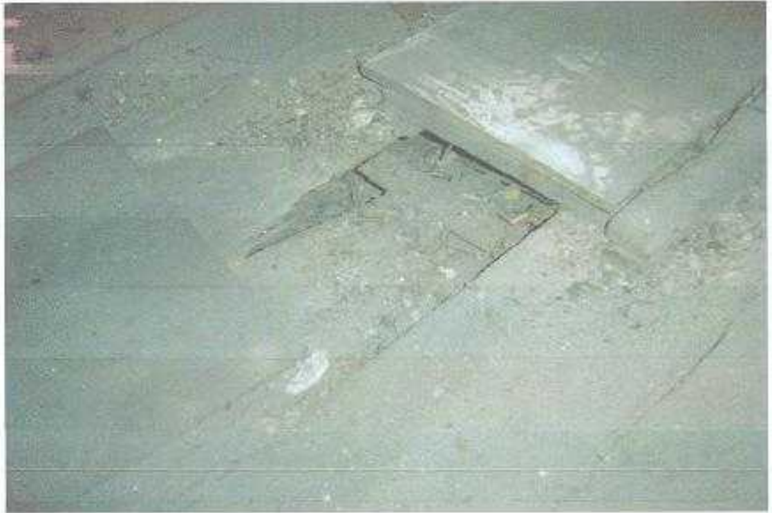
Fot. 3. Widoczne uszkodzenia podłogi – spróchniałe deski na skutek zawilgocenia w miejscu przecieku.
